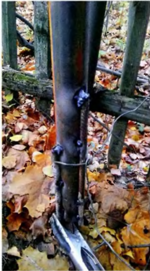
Арматура сварена с трубой.
