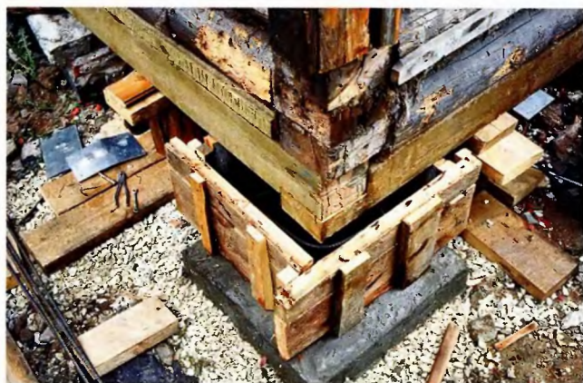
Опалубка для изготовления бетонного столбика. К началу этой работы плита должна «схватиться» на что нужно не менее двух дней.
