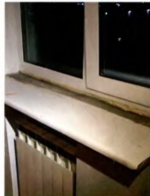
К сожалению, фирма напутала с размерами окна при замерах, и старый подоконник оказался ниже оконной рамы. Нам придётся нарастить подоконник по высоте.
