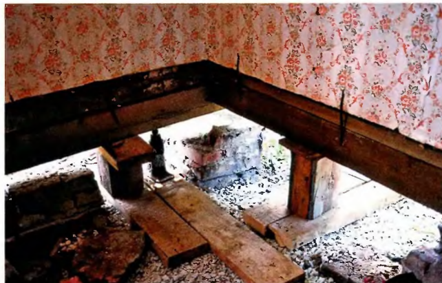
Сруб с новой нижней обвязкой стоит на временных опорах. Новый и старый венцы сруба соединили между собой металлическими скобами.
