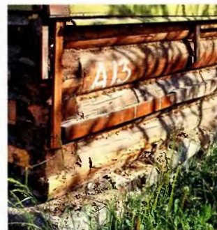
Брёвна нижнего венца сильно пострадали. Необходимость ремонта очевидна.
